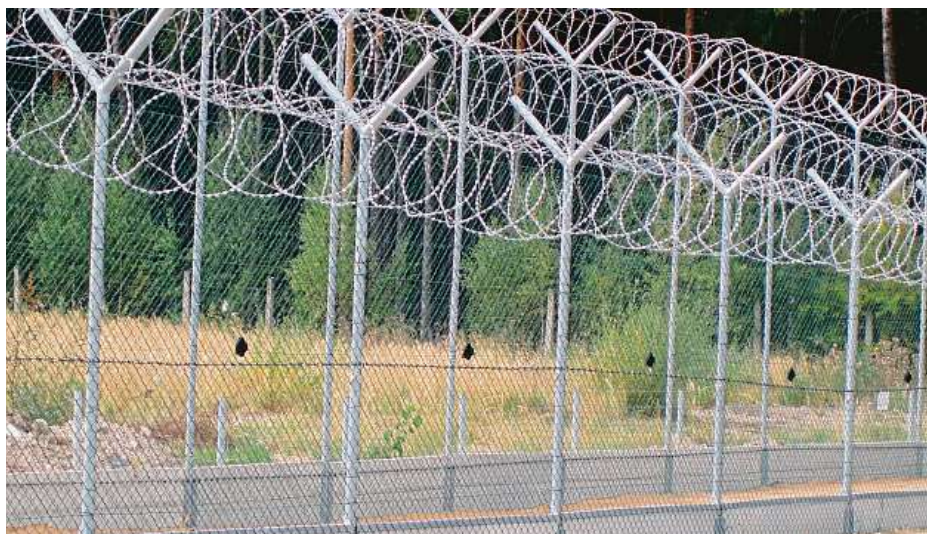
Perimetrický systém Peridect+ – instalovaný na oplocení
